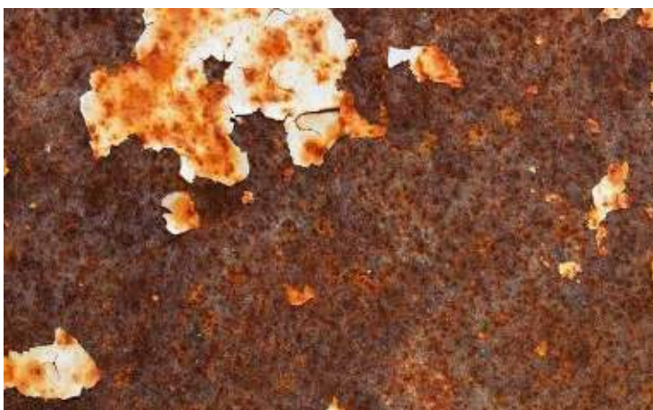
Fig 6.11 Coroziune uniformă – rezervor
