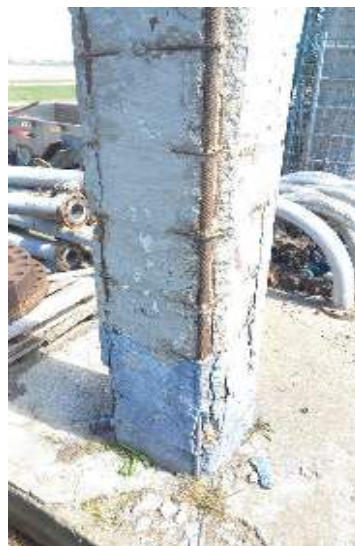
Fig 5.2. Stâlp cu beton de acoperire
