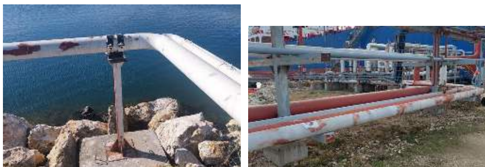
Fig 5.6, 5.7 stare tehnică precară a conductelor (sursă autor)
