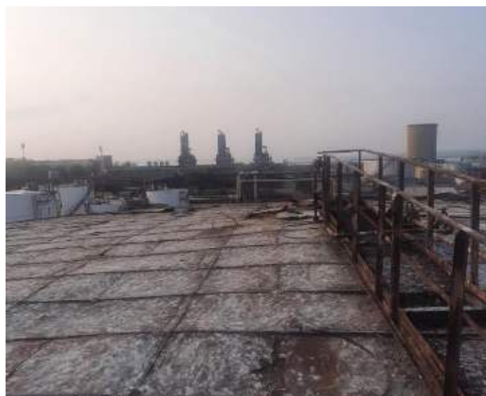
Fig. 5.3 Protecție tabla corodată (sursă autor)
