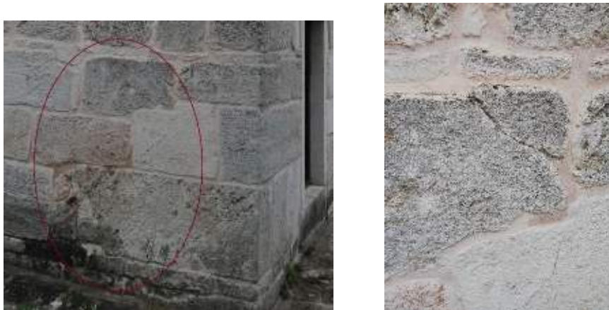
Fig.3.3. Fisurarea și dezintegrarea pietrelor de zidărie – geamia Esmahan Sultan (foto autor)
