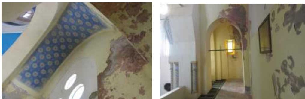
Fig.3.4. Moscheea Carol I – zone degradate ale pereților interiori (foto autor)
