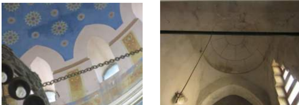
Fig.3.5. Moscheea Carol I – zone degradate la nivelul cupolelor (foto autor)
