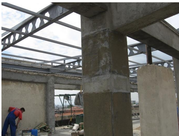
Fig. 4.6 Reparații finale cu sisteme compozite la stâlpi (foto arhiva personală - Univ. Maritima din Constanta)
