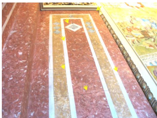
Figura 3.21 - Muzeul de Istorie Nationala si Arheologie – Constanta - detalii cu fisuri din sala pictata de la etalul 1, holul
