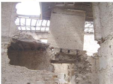
Figura 3.29 - Str. Nicolae Titulescu nr.30A - fatada principala spre str. Ovidiu - elemente structurale grav avariate -
