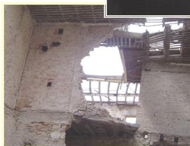
Str. Ovidiu - constructie in stare de precolaps -
