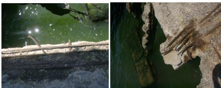
Fig.5.20,21- Degradarea elementelor din beton la Pasarela Casino Mamaia(foto autor)
