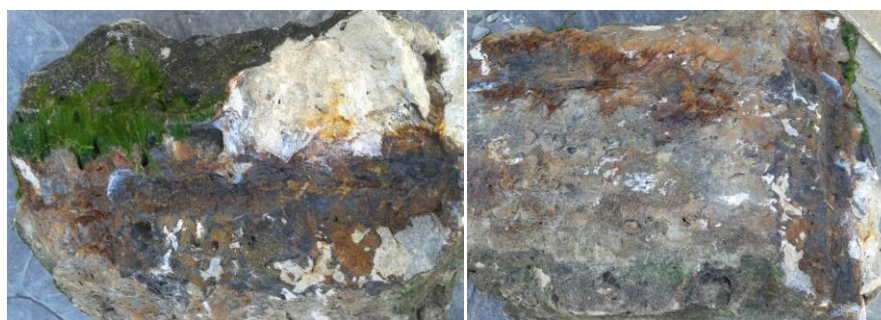
Fig.3.10,11-Zone de beton expulzat , prelevate de la Pasarela Casino Mamaia(foto autor)
