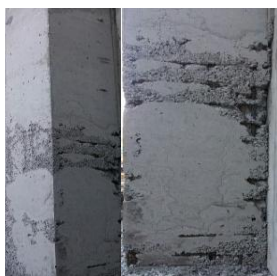
Fig.2.2-Zonă de stâlp segregat
