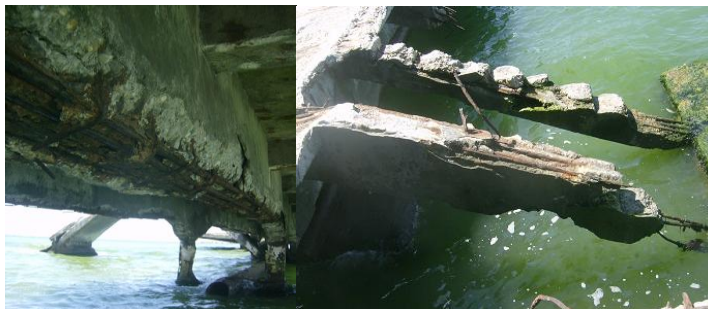
Fig.3.13,14-Elemente de beton degradate Pasarela Casino Mamaia(foto autor)
