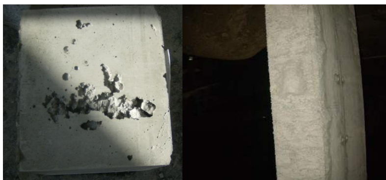
Fig.2.22,2.23- Zonă de beton compactată defectuos: laborator și șantier (foto autor)
