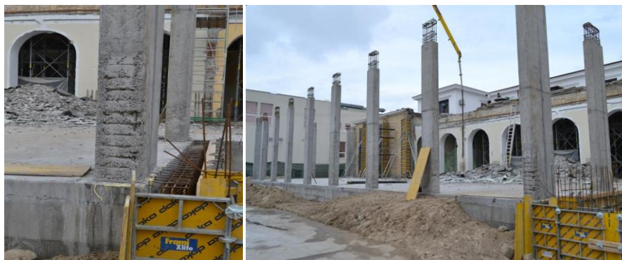
Fig.4.33,4.34- Elemente de construcție compactate defectuos , datorită înălțimii mari a elementelor (foto autor)
