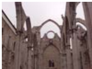
Fig. 3.43 – Bolți prăbușite din cauza acțiunii seismice - Biserica Cârmo/Lisabona – (foto autor)
