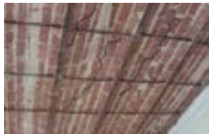
Fig. 3.36 - Fisuri și crăpături în zidăria bolților de cărămidă – (foto autor)
